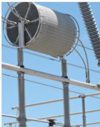
Montaje sobre 2 columnas de aisladores
