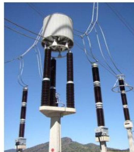
Montaje sobre 3 columnas de aisladores
