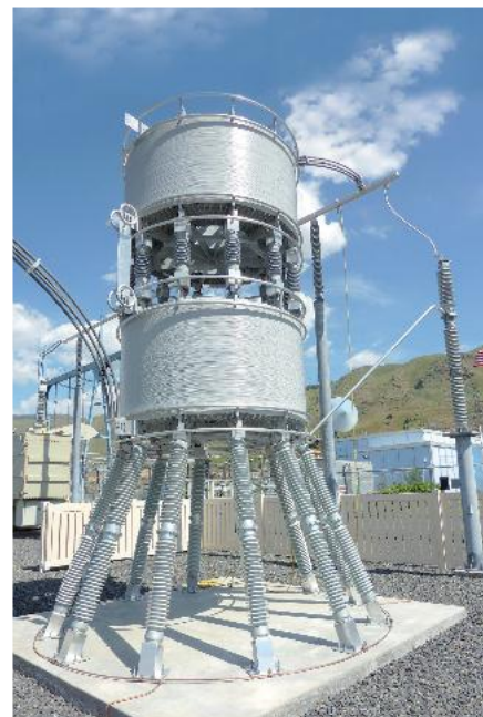
1.1 Токоограничивающие реакторы с сейсмическим проектированием
