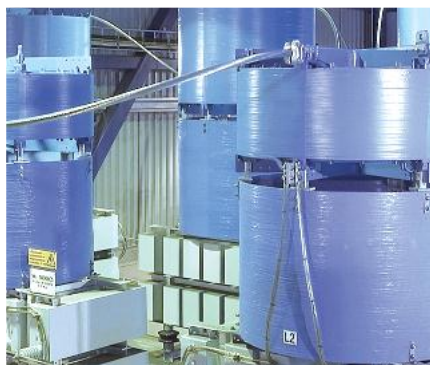
1.5.1 Реактор для систем СТКРМ – ФКУ (статические тиристорные компенсаторы реактивной мощности – фильтро-компенсирующие устройства)
